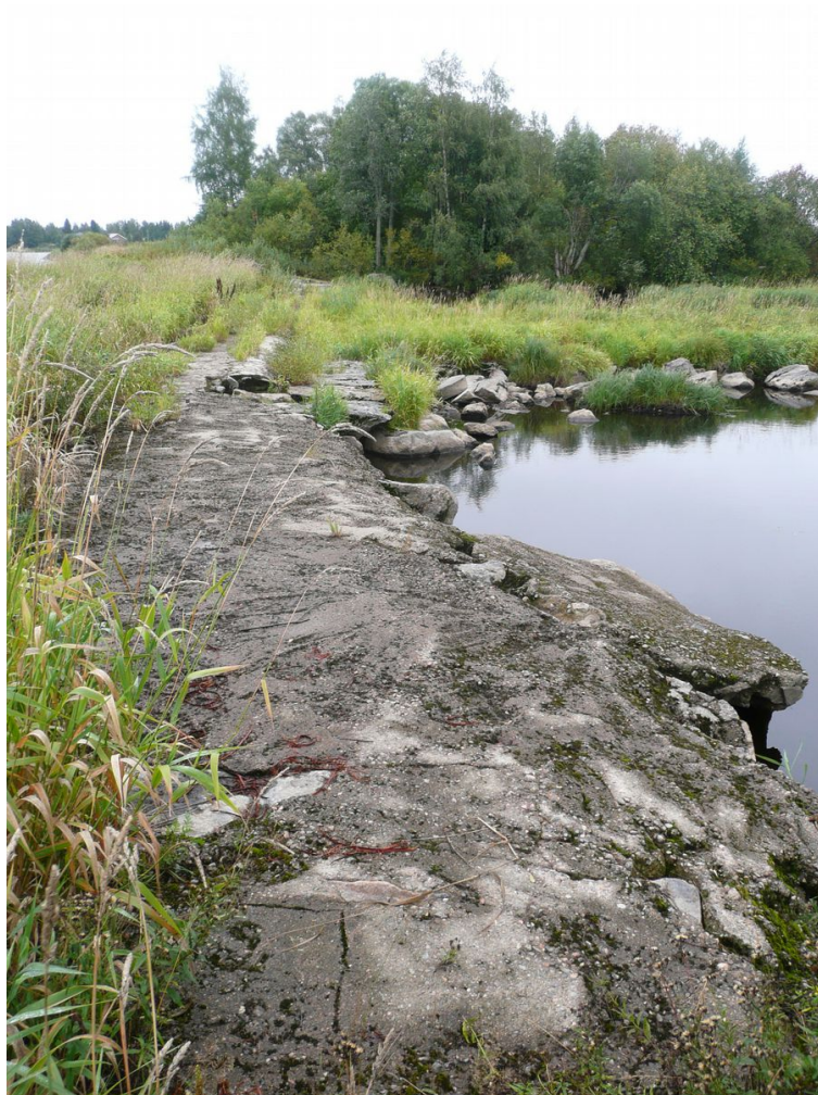
Kuva 18. Betonipatoa kuvattuna pohjoisesta.
