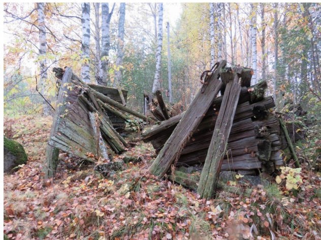
Romahtanut rakennus kosken länsirannalla Kuurtajantien pohjoispuolella.
