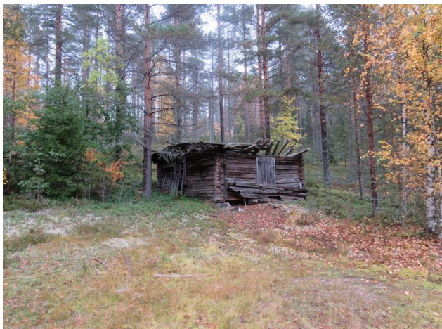
Romahtanut hirsirakennus Myllylässä kosken itärannalla.
