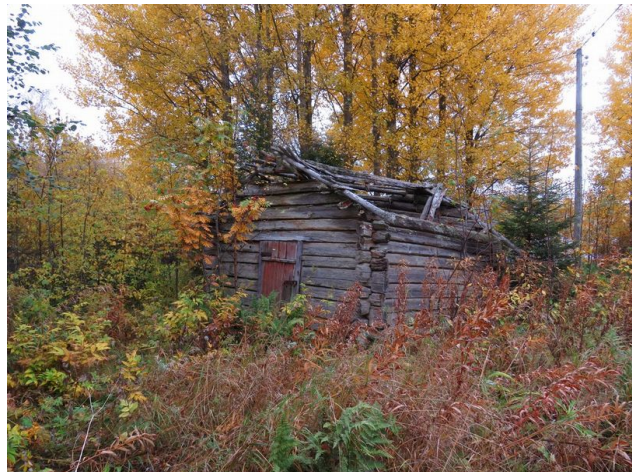
Katoltaan romahtanut rakennus Myllyniemen pihapiirissä.
