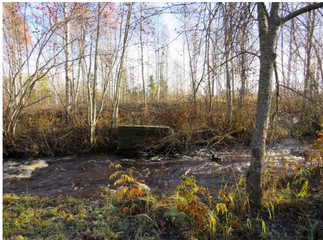
Betonipadon jäännös johdinaidan länsilaidalla, kuva itään.
