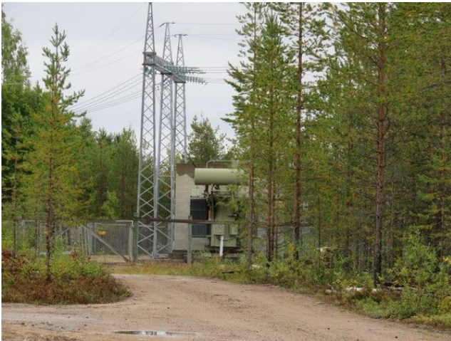
Kuva 25. Pudasjärven muuntoasema kuvattu itään.
