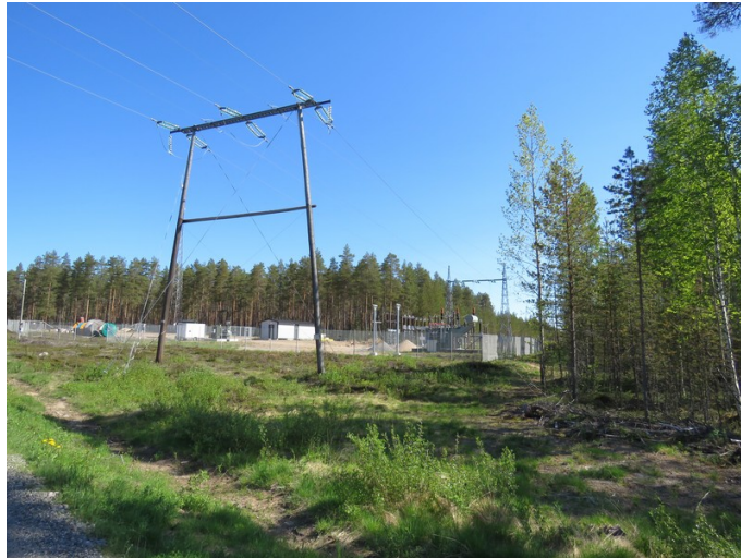
Kuva 8. VE 1. Kankaanpään sähköasema.
